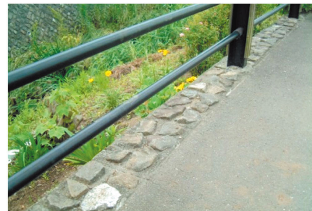
天端部分の不明瞭な仕上げ
